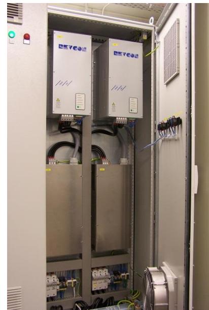
Zdj. 3 Rozdzielnica z zabudowanymi modułami REVCON®
