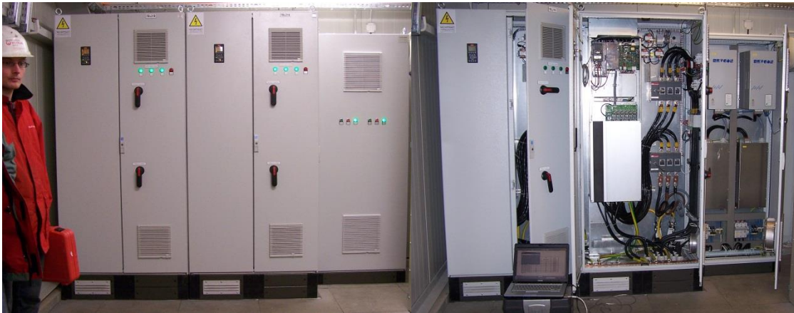
Zdj. 1,2. Widok przetwornic częstotliwości Danfoss FC 302 o mocy 315 kW wraz z rozdzielnicą z modułami REVCON®.
