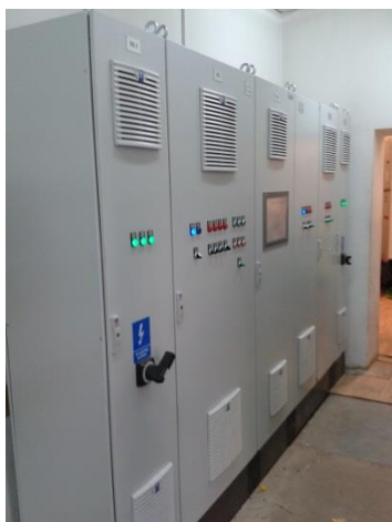
Zdjęcie 1. Rozdzielnice zasilające i sterownicze systemu zasilania w wodę
